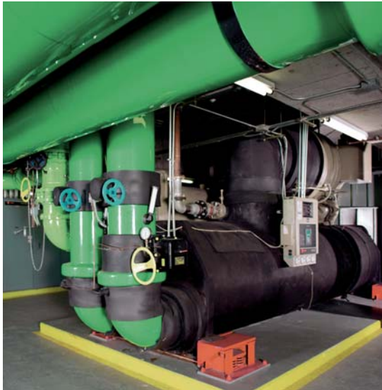
Una unidad de refrigeración en el tejado de un edificio industrial (Guangzhou, China).
