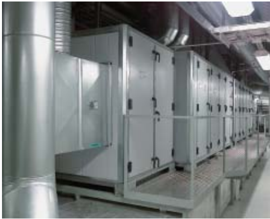
Unidad de climatización con cuadro de conmutación eléctrico.
