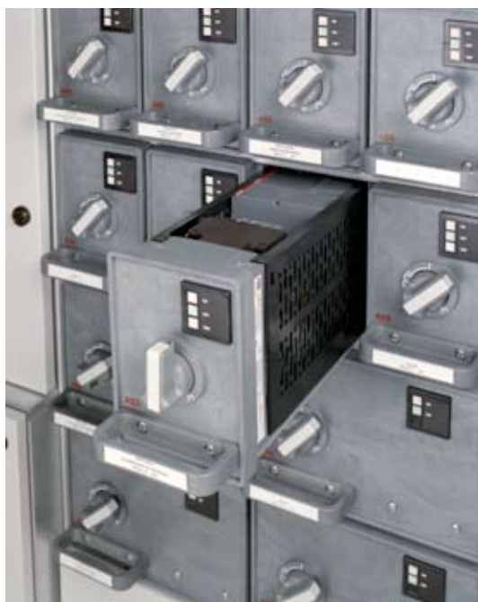
Sadales iekārtas ar izvelkamiem moduļiem piemērs. Viens modulis pārvietošanas stāvoklī, citi TEST (pārbaudes) stāvoklī.
