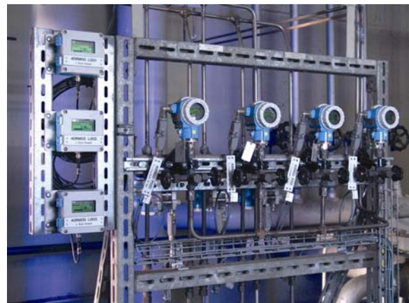
Neue Messumformer auf vorhandenem Messgerüst
