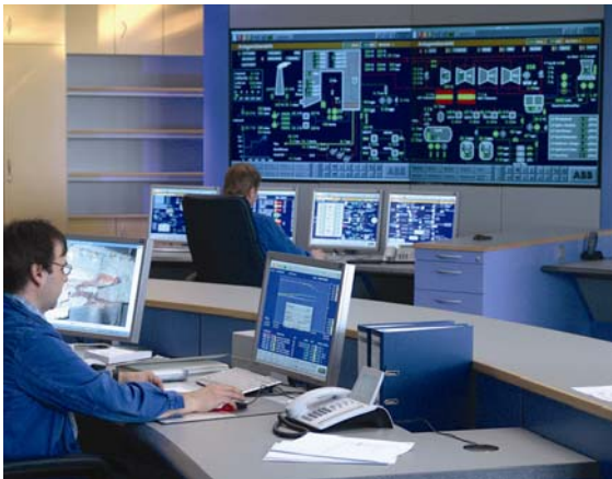
Blick vom Blockmeisterpult auf den Leitstand Block 4
