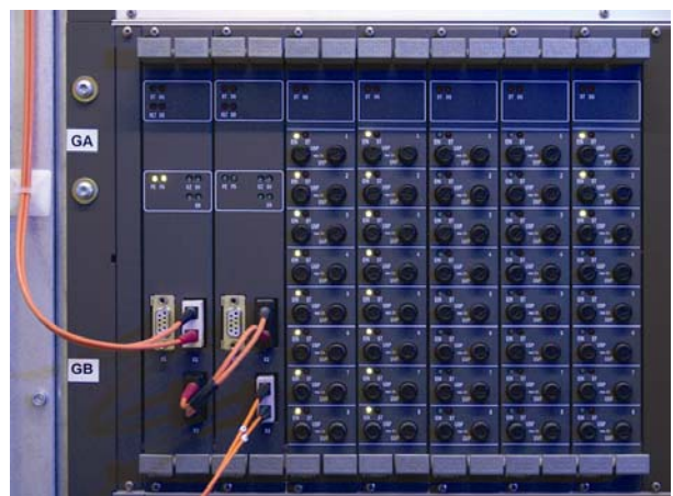
Buskopplung mit Ausgabegeräten beim Procontrol P Kesselschutz
