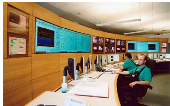
PIMS sorgt für optimale Anlagenfahrweise
