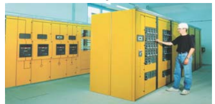
Elektrische Ausrüstung, MCC
