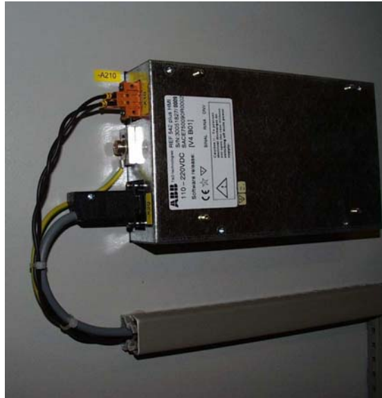
Bild 23: Erdung des HMI- Vor-Ort-Steuereinheit des REF542plus
