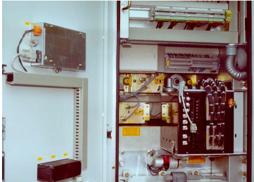
Bild 20: Beispiel für den Einbau der Zentraleinheit in die Niederspannungsnische und der HMI in die Tür
