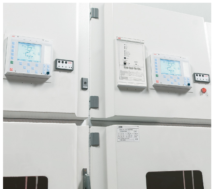
Schutz- und Steuergeräte der 630-Serie und das Lichtbogenschutzsystem REA wurden in die Unigear-Schaltanlage von ABB eingebaut.
