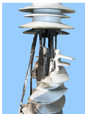
Figura 4. Prueba en cortocircuito fallida en ensayos sin arrollado de correa.
