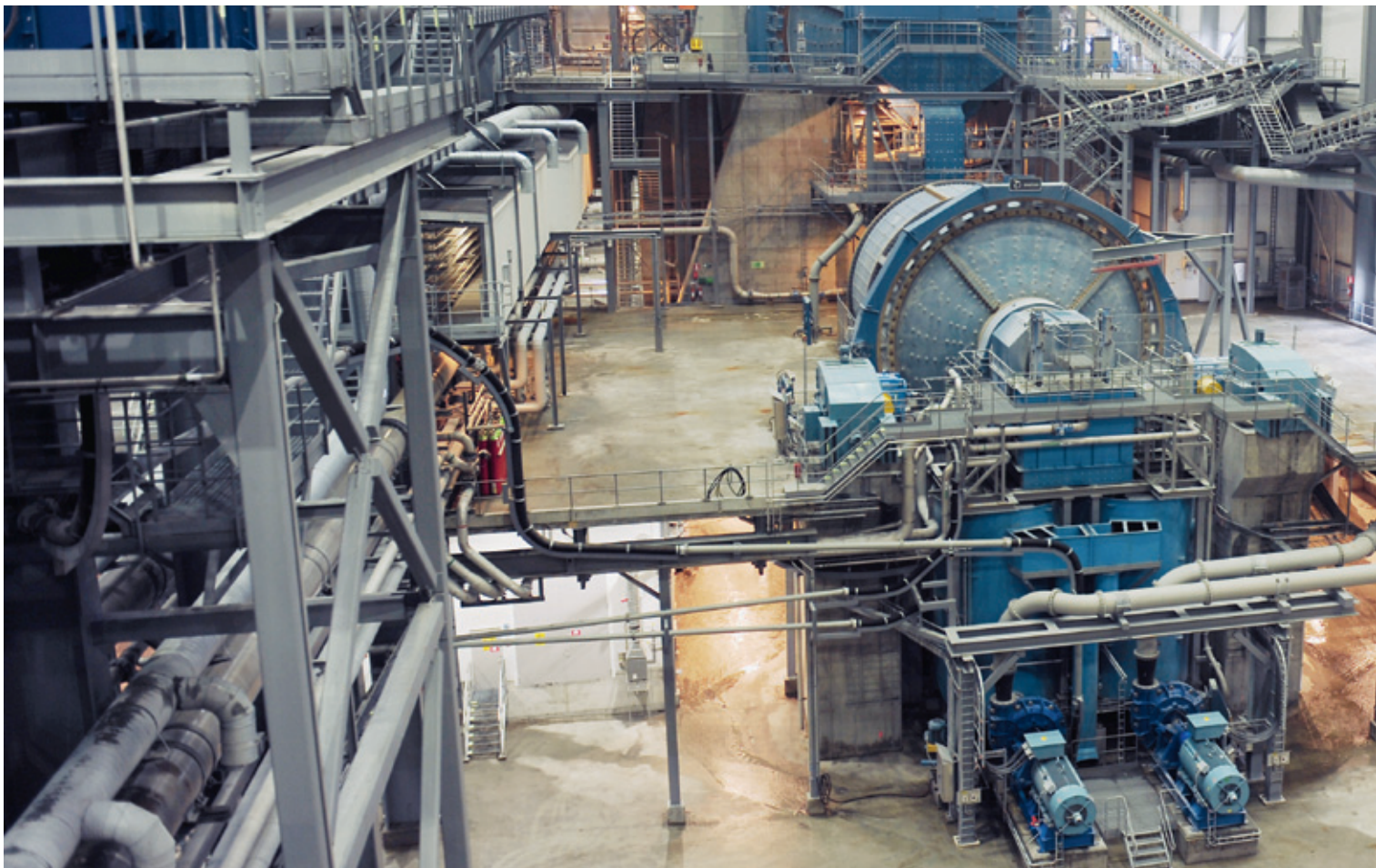
Det nya anrikningsverket i Aitik har kapaciteten att mala över 100 000 ton malm per dygn till sand, inför flotationsprocessen som särskiljer mineraler från gråberg.
